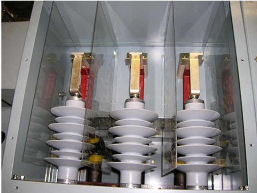
نبودن ارستر در کلید افزار یکی از دلایل اضافه ولتاژ است
